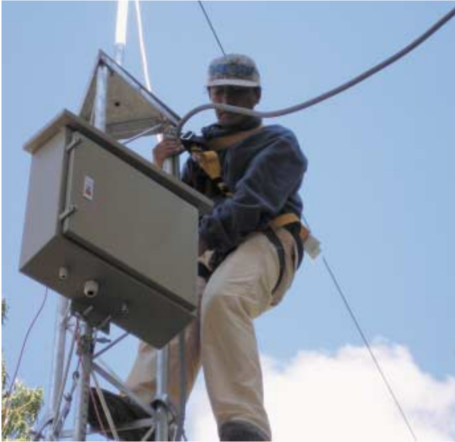
Instalación de equipo en el Centro de Demostración y Capacitación en Tecnologías Apropriadas.
